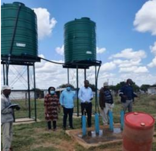
Pozos y tanques de agua
