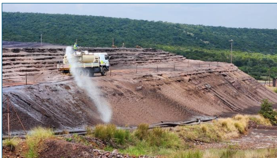
Se está llevando a cabo una rehabilitación simultánea en la TSF5 donde los taludes están siendo hidrosebrados, lo que proporciona rápidamente una superficie con vegetación para evitar la generación de polvo
